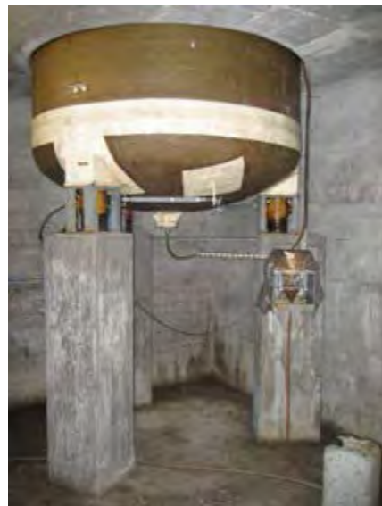
Lysimeterkeller mit Kippwaage für Sickerwassermessung.
